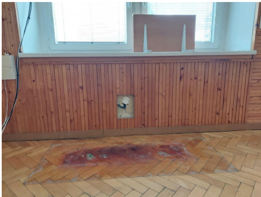
Poškozené parkety po akumulacích kamnech.
